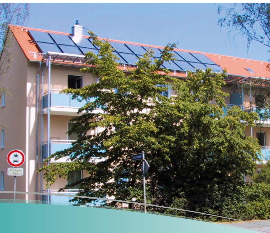
Bild 12: Solarthermieanlage mit 50 m 2 Fläche auf einem Mehrfamilienhaus
