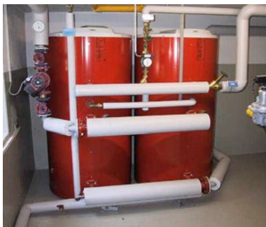
Bild 5: Warmwasserspeicher für zentrale Warmwasserbereitung
