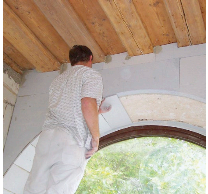
Bild 20: Innendämmung (Quelle: Stadt Nürnberg, Kommunales Energiemanagement)
