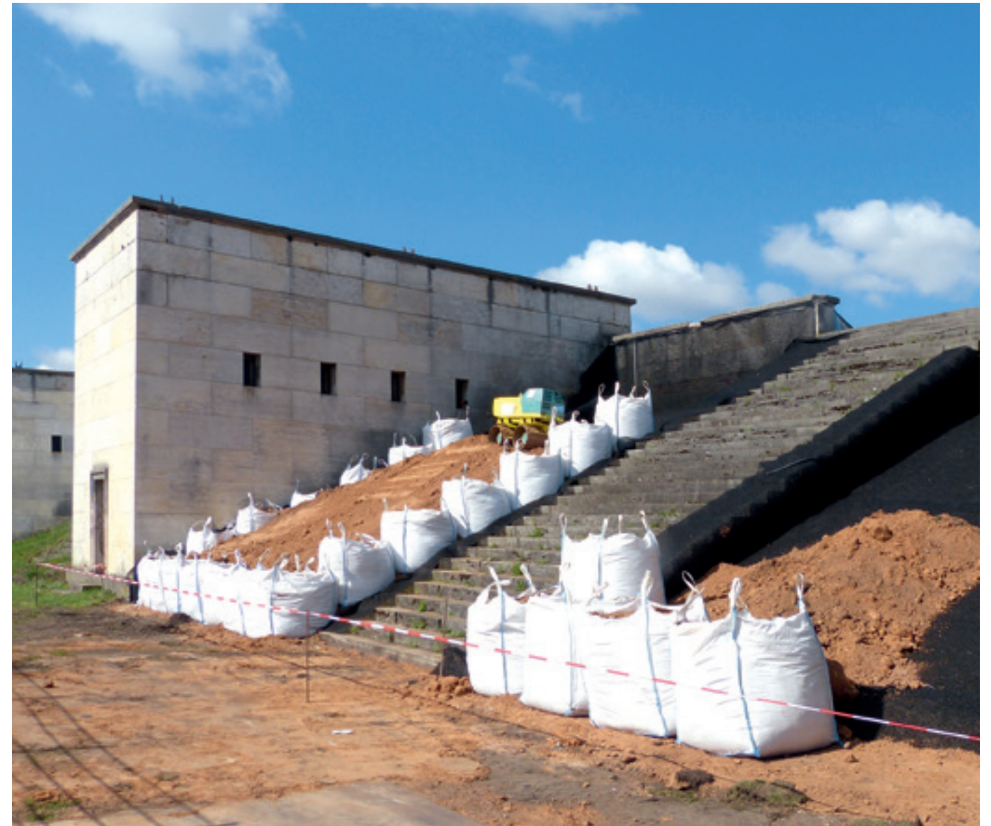
Test an einem Abschnitt der Wallanlage: Eine „Nachverdichtung“ mit schweren Sandsäcken führt nicht zum Erfolg.
