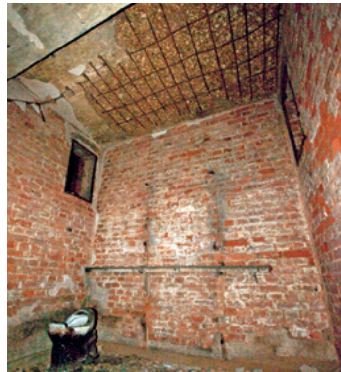
Feuchtigkeit sorgt im Inneren der Zeppelintribüne für Korrosion an der Bewehrung (oben).
